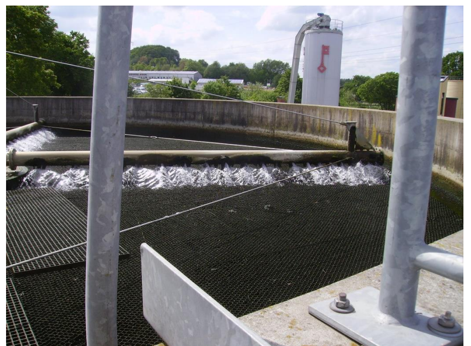
Abb. 5. Tropfkörper mit Drehsprenger (Foto: Elger)
